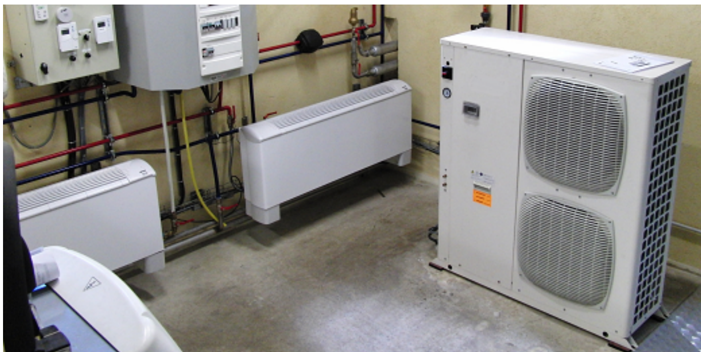
Plateforme QualiPac du CETIAT
